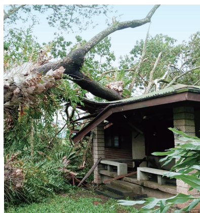
倒木により、バゴ研修センター宿舎の屋根が破損
